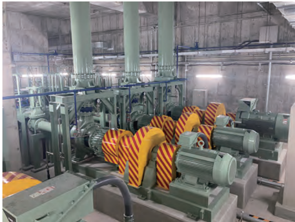
図4 汚水送水ポンプ室全景
