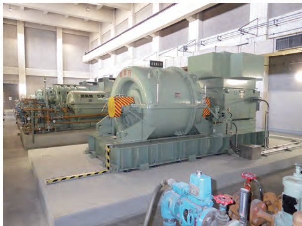
図9 送風機室全景
