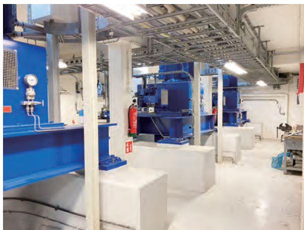
図10 ウェストランドポンプ場内
