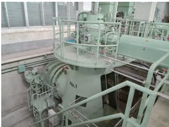
図2 ポンプ設備 (No.1主ポンプ)
