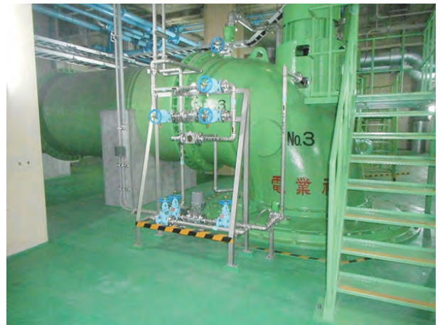
図5 雨水ポンプ設置状況
