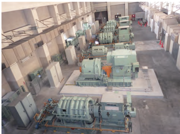
図8 送風機室全景
