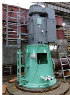
バイオマス発電用循環水ポンプ
