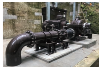
エコタービン(ポンプ逆転水車)
