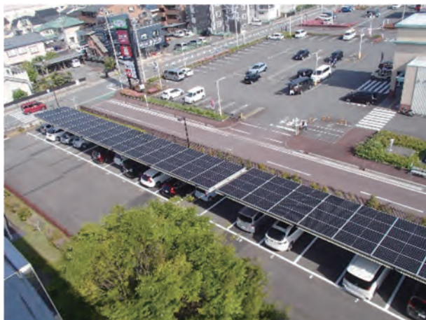
図2 カーポート型太陽光発電設備 Fig.2 Carport-type solar power generation facility.
