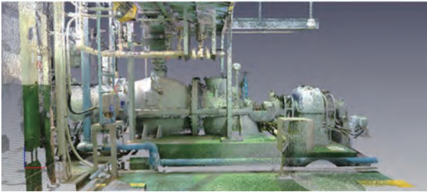
図5-1 ポンプ更新前-点群データ図 Fig.5-1 Before pump update - point cloud
