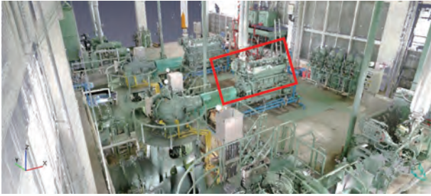
図2 機場全体点群データ図 Fig.2 Pump station Point cloud
