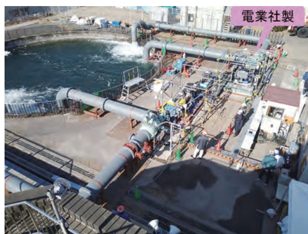
図3 実証試験状況（上が電業社のポンプ試験設備）
