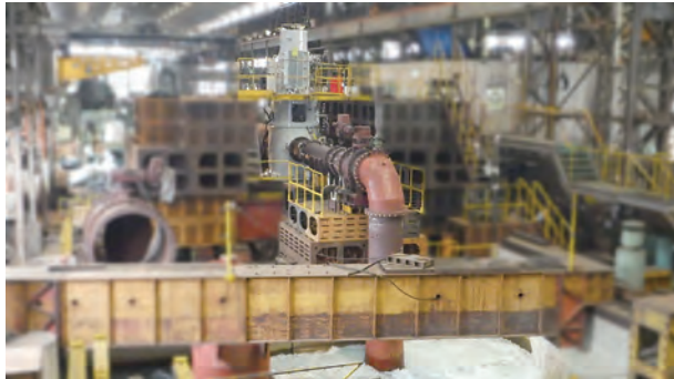
図9 温水ポンプ工場試運転の様子
