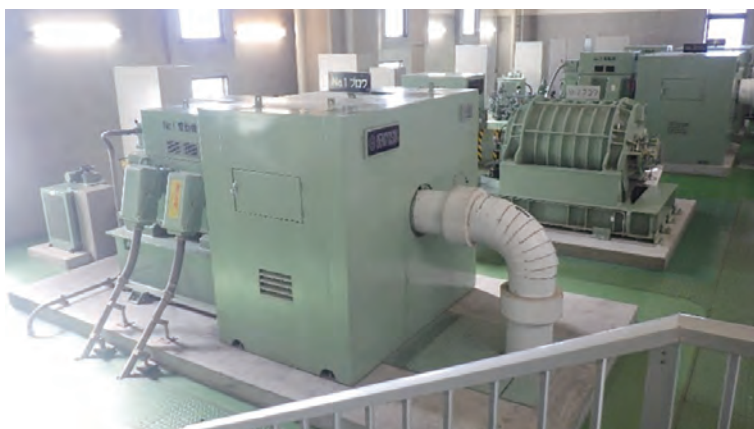
図1 既設機場写真
