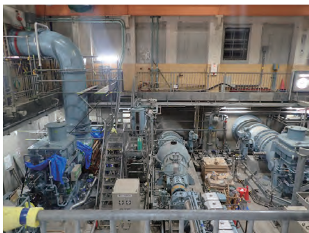
図1 ポンプ場内写真（2022年4月時）
