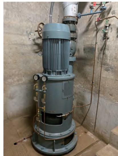
図6 冷却水給水ポンプ
