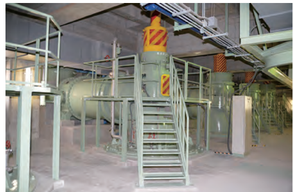
図2 雨水ポンプ設置状況
