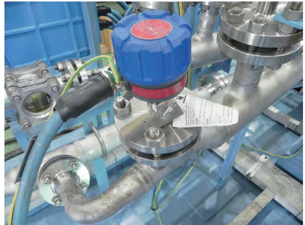
図4 潤滑油配管ノーフロースイッチ Fig.4 No Flow Switch on Lubricating Oil Piping
