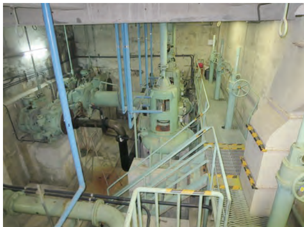
図1 既設ポンプ写真
