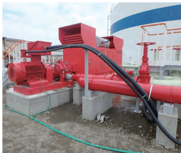
図3 消火ポンプ設備
