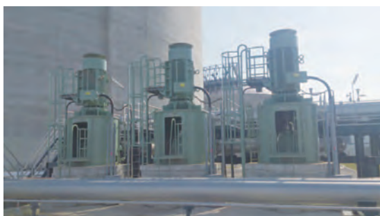
図3 海水ポンプ設置場所
