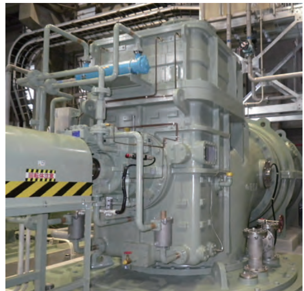
図3 雨水ポンプ外観
