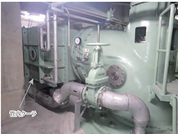
図4 管内クーラの写真 Fig.4 View of inline cooler
