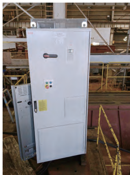
図9 可変速制御盤
