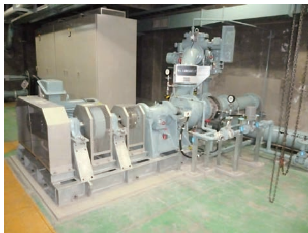
図4 余剰汚泥ポンプ
