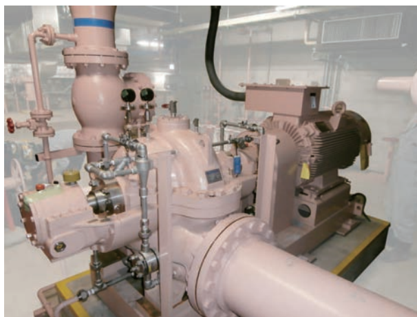
図3 主給水ポンプ外観
