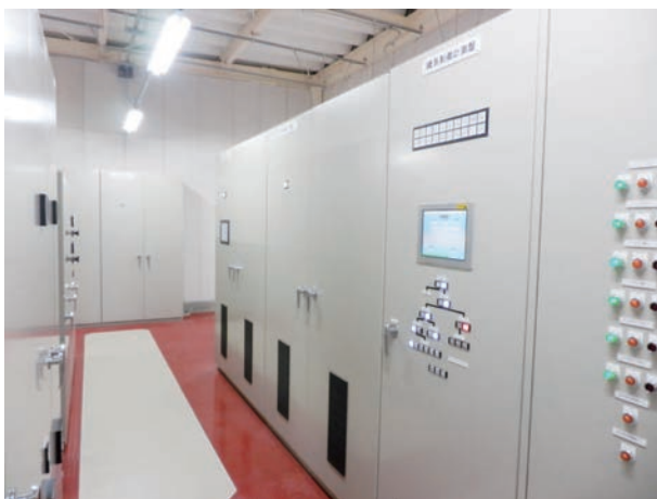
図4 換気制御計測盤・換気動力盤外観
