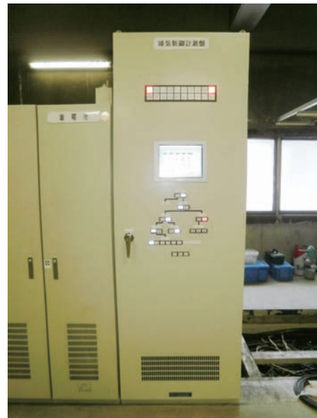
図6 換気制御計測盤外観
