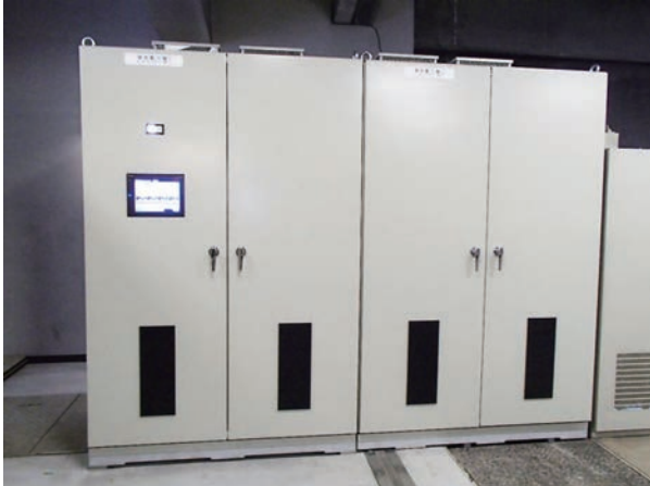
図5 換気動力盤外観
