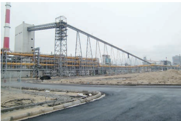
図1 コークスプラント概観 Fig.1 View of coke plant
