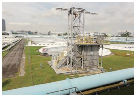
図2 ウルパンダン水再生センター Fig.2 Ulu Pandan water reclamation plant
