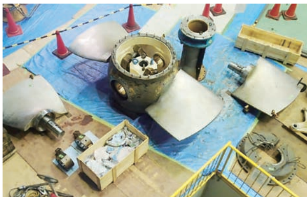
図3 主ポンプ分解状況 Fig.3 Resolution situation of main pump
