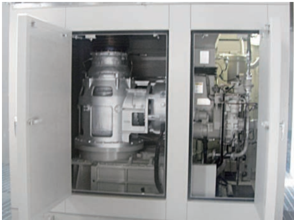
図5 ガスタービン内部 Fig.5 Internal view of gas turbine
