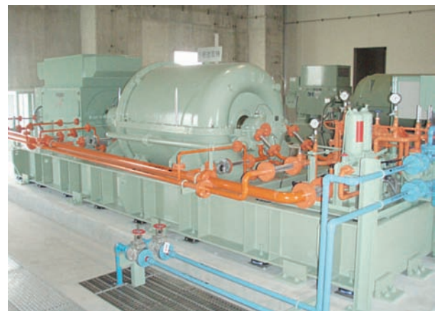
図13 送風機設置状況
