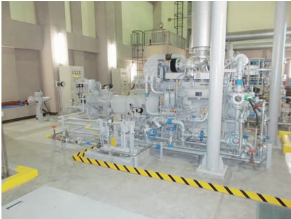
図3 原動機室全景
