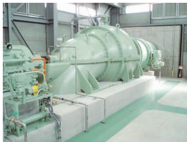
図1 排水機場における設置例 (1) Fig. 1 Installation example on drainage station
