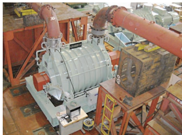
図4 社内試運転 Fig.4 Shop test
