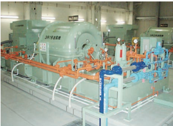
図11 送風機設備設置状況
