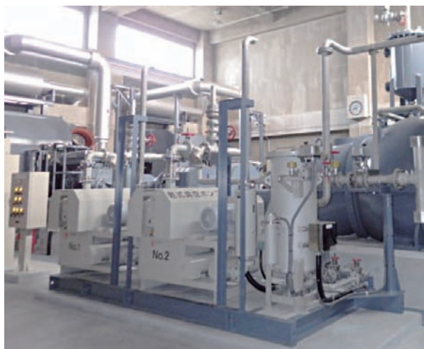
図4 真空ポンプユニット Fig.4 Vacuum pump unit
