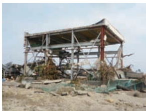
図1 被災直後の機場外観
