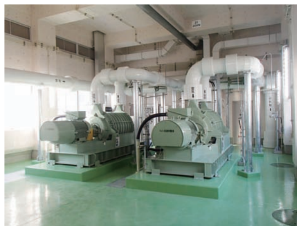
図9 送風機設置状況
