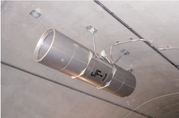
図10 ジェットファン設置状況
