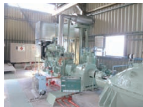
図2 完成後の機場内部
