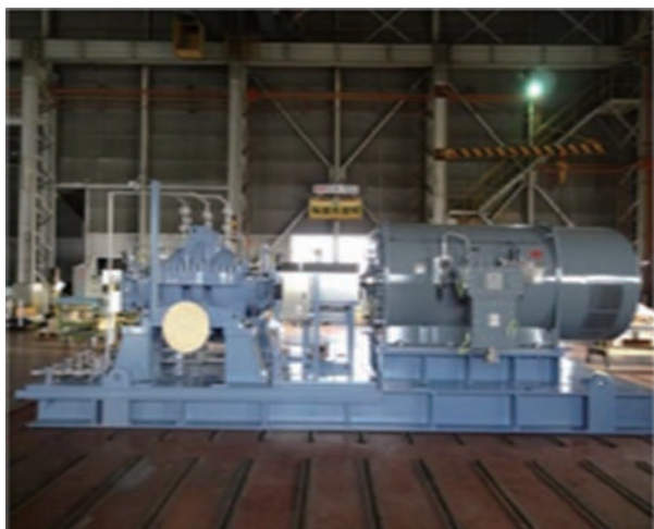
図8 ブースタポンプ
