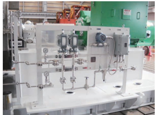
図4 ドライガスシールシステム Fig.4 View of dry gas seal system
