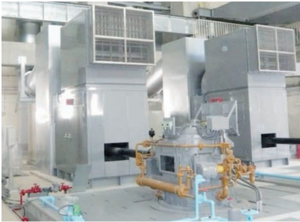
図4 原動機の外観 Fig.4 View of gas turbines
