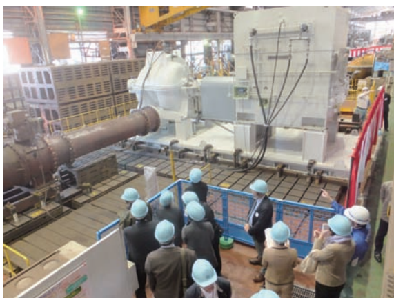
図4 両吸込渦巻ポンプの運転状況
