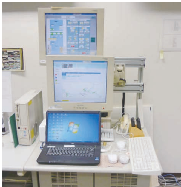
図2 遠隔監視操作システム（豊岡出張所内）
