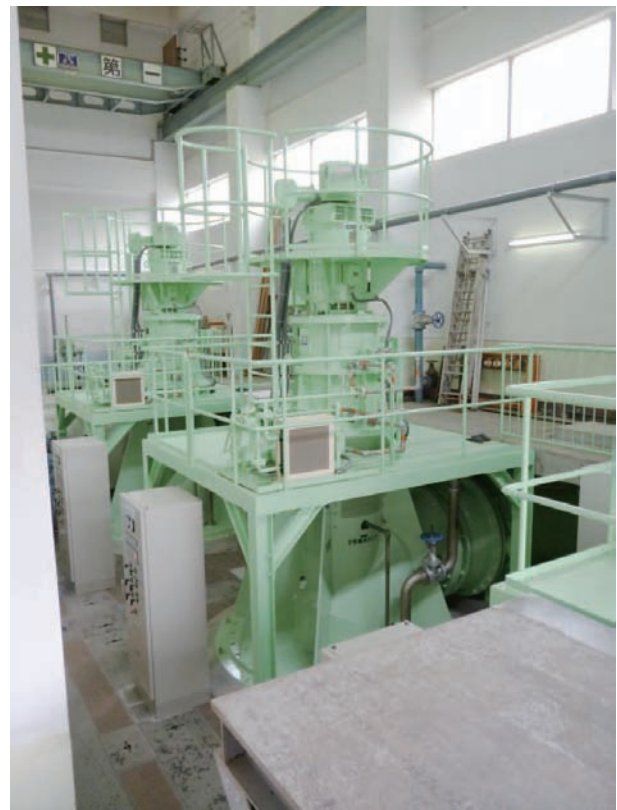
図2 雨水ポンプ据付外観
