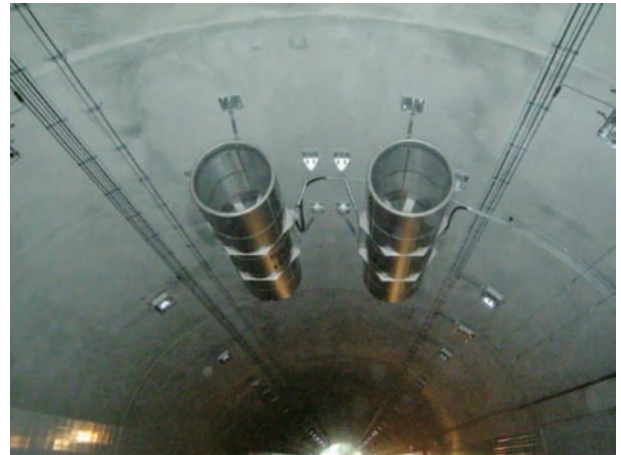
図17 ジェットファン設置状況
