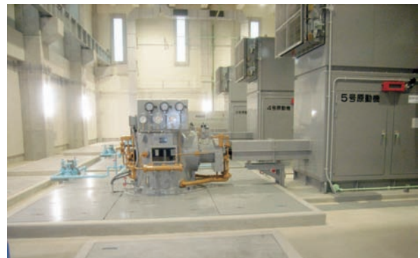
図2 原動機室全景
