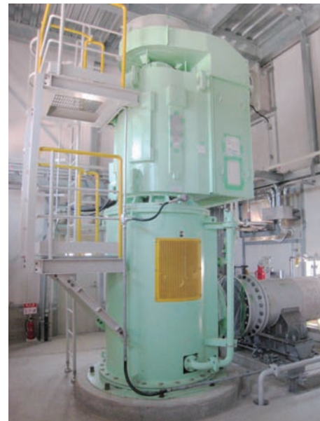
図12 気化器海水ポンプ
