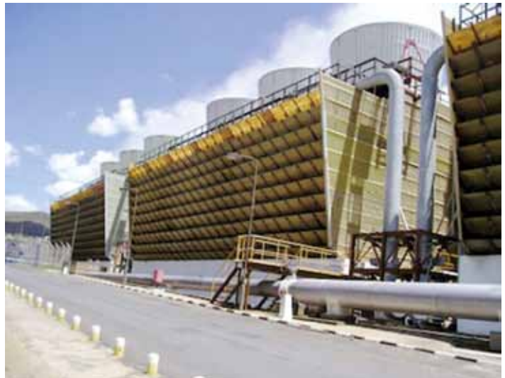
図2 オルカリア1号地熱発電所
