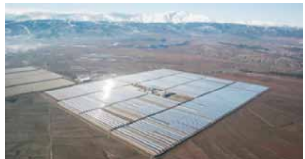
図6 アンダソル太陽熱発電所
