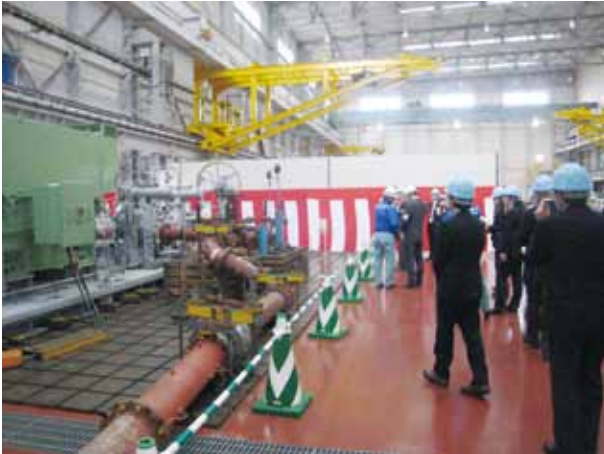
図6 ボイラフィードポンプの運転状況
