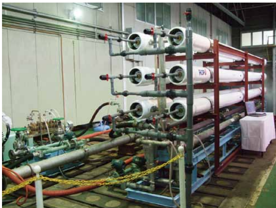
図1 エネルギー回収装置と逆浸透膜ユニット
