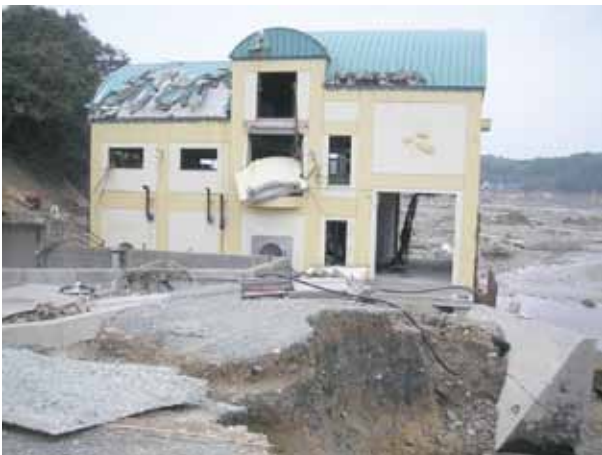
図9 被災後機場外観
