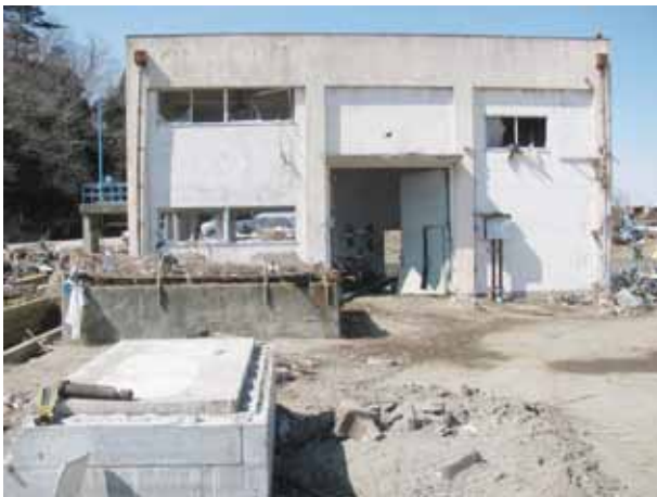
図5 被災後機場外観
