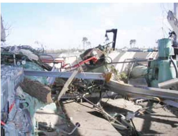
図2 被災後ポンプ場内外観
