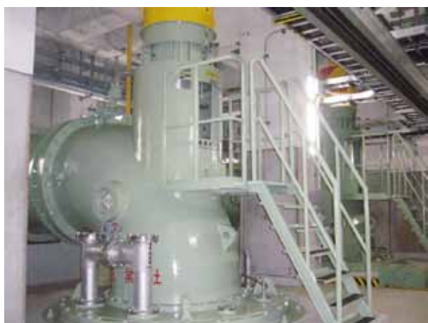
図1 3号雨水ポンプ設置状況
