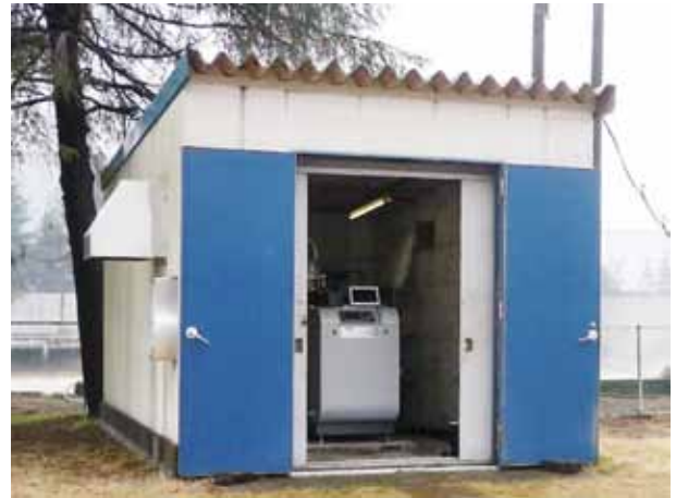
図13 ブロワ設置状況
