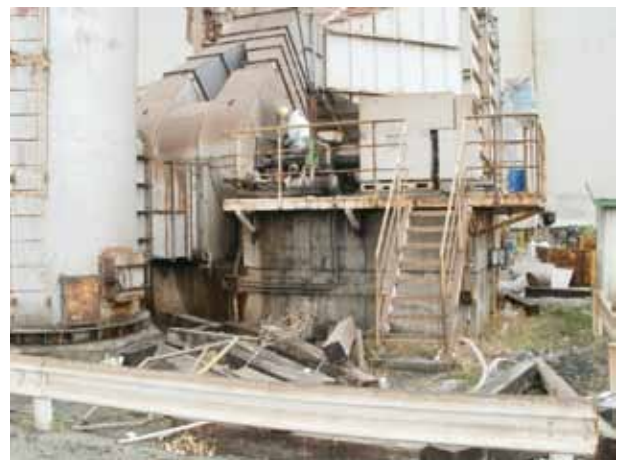
図11 被災後送風機外観（#10両吸込形翼形送風機）
