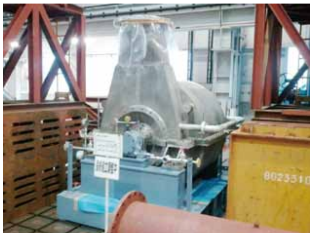
図15 ブロワ設備外観
