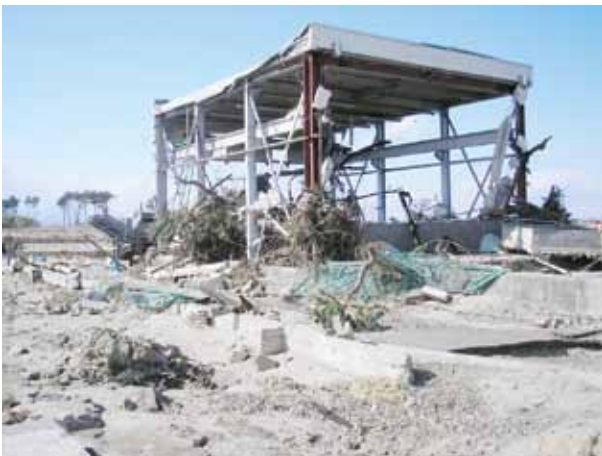
図1 被災後機場外観
