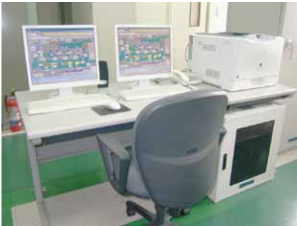
図3 ディスプレイ監視制御システム Fig.3 View of monitor operation control
