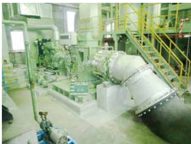
図1 据付後のポンプ外観
