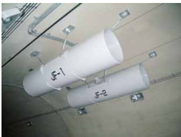
図13 ジェットファン設置状況
