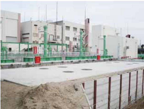
図7 燃料タンク設置状況 Fig.7 View of fuel tank
