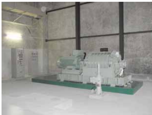
図15 送風機設備外観
