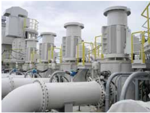
(a) 気化器海水ポンプ・消火海水ポンプ
