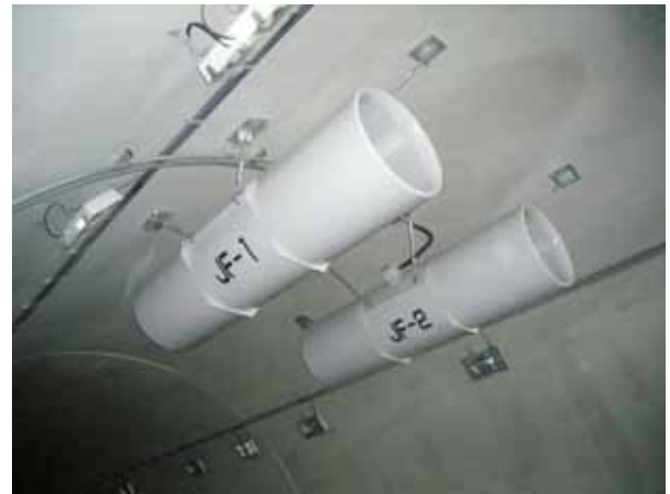
図11 ジェットファン設備
