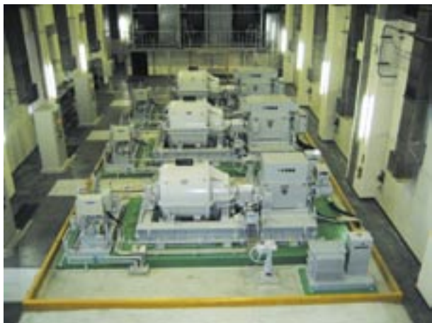
図 17 送風機設備外観
