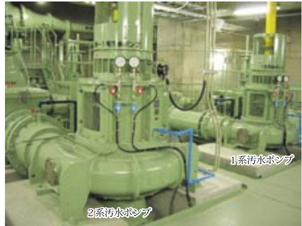
図4 汚水ポンプ Fig. 4 Sewage pumps
