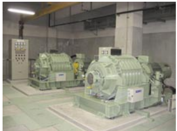
図16 送風機設備外観
