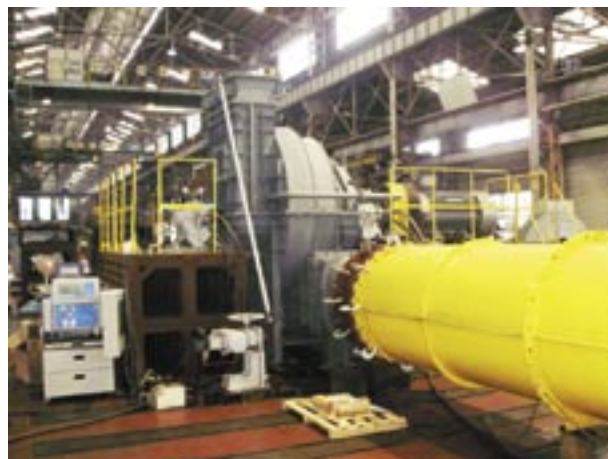
図 18 送風機設置状況
