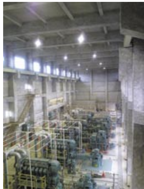
図5 ポンプ場建屋内
