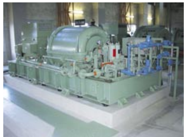
図13 送風機設備外観
