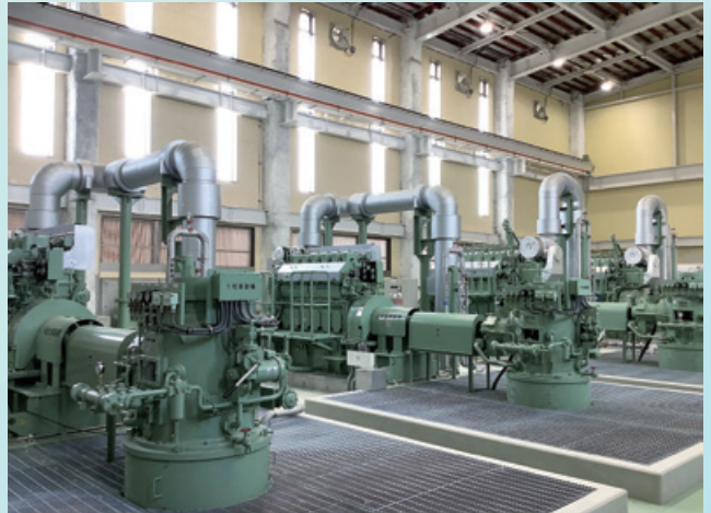
与良川統合排水機場内ポンプ駆動機室
