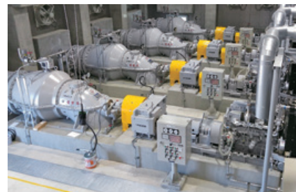
●排水機場向け排水ポンプ
