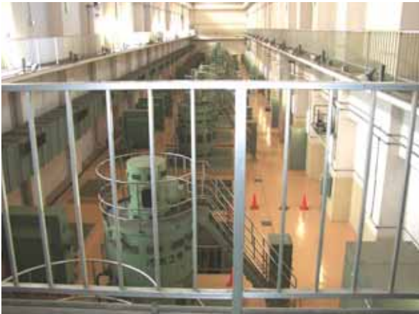
図2 ポンプ室全景 Fig.2 View of pump room
