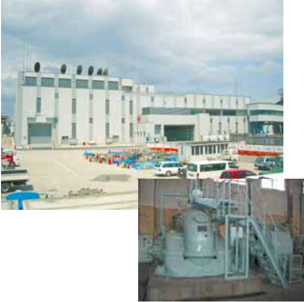
図2 新ポンプ棟と第1ポンプ室の汚水ポンプ
