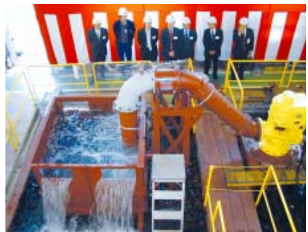
図7 サイホン運転状況
