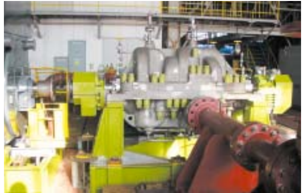
図2 ポンプの外観
