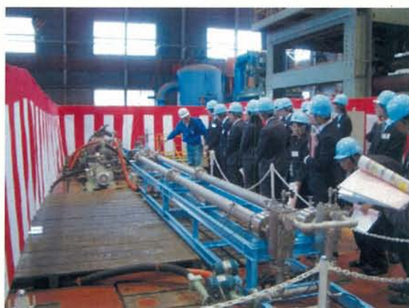
図4 エネルギー回収システム開発試作機の運転状況
