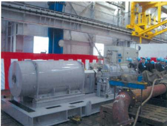
図1 水平二ツ割横軸高圧多段ポンプの運転状況
