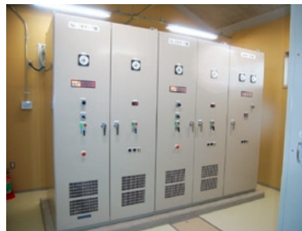
● 消流雪ポンプ設備向け制御盤
