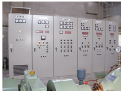
●排水機場向けポンプ制御盤
