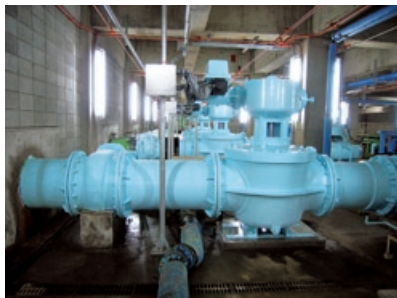
●浄水場導水ポンプ吐出圧制御用ACサーボモータ駆動ロートバルブ
