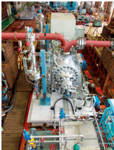
●製油所用バレル型高圧多段ポンプ工場試運転状況
