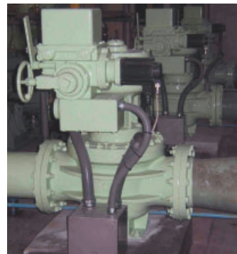
● 上水道取水ポンプ吐出制御用 ACサーボモータ駆動ロートバルブ
