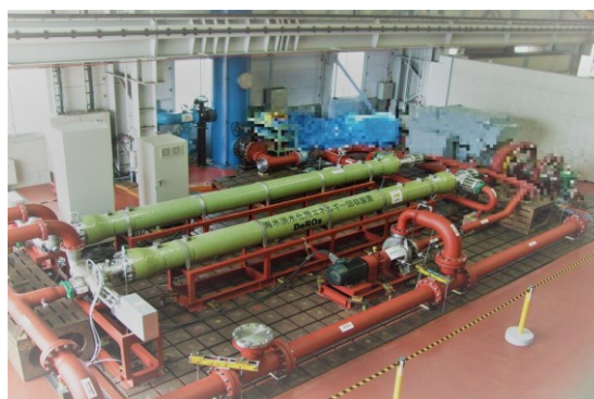
エネルギー回収装置とポンプ
