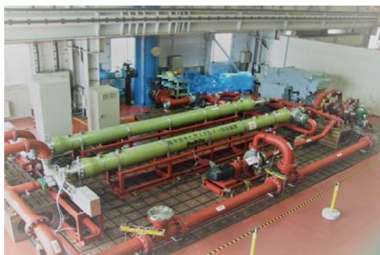
エネルギー回収装置とポンプ
